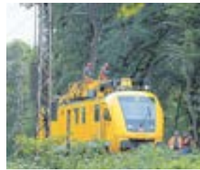
Vom Reparaturzug aus fährt eine Hebebühne die Bahnmitarbeiter bis an die Oberleitung heran, wo sie ihre Arbeiten durchführen können.
