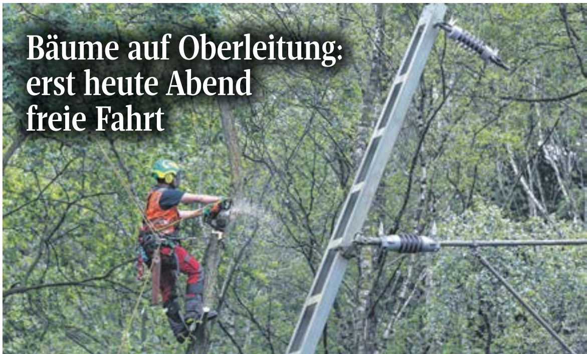
Bahnmitarbeiter beschneiden mit Motorsägen Bäume entlang der Bahnstrecke zwischen Nienburg und Linsburg. Hier waren Äste auf die Oberleitung gefallen
