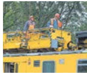
Die beiden Bahnmitarbeiter warten auf den Hebebühnen des Reparaturzuges auf ihren Einsatz an der Oberleitung.
