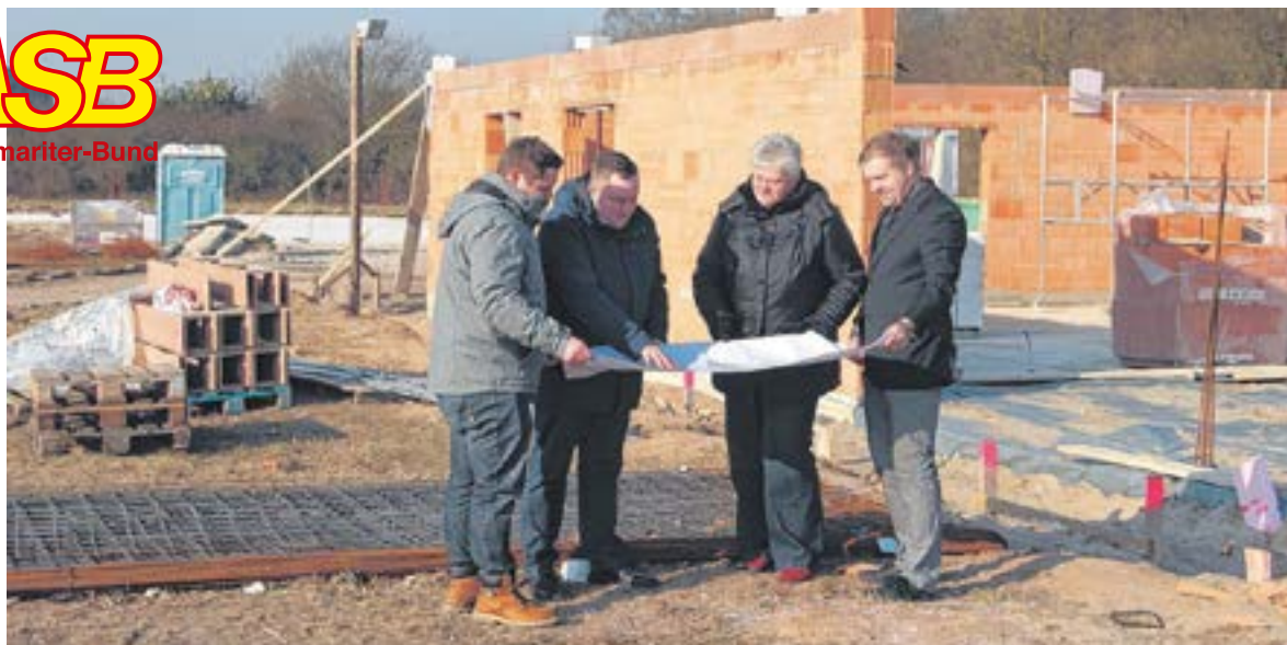
Rettungsdienstleiter Nico Lorenz, ASB-Geschäftsführer Jens Sewohl, Pflegedienstleitung Hella Bösel und Stolzenaus stellvertretender Gemeindedirektor Jens Niemeyer (von links) studieren den Bauplan.
